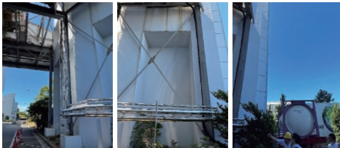
CO 2 分離・回収装置
