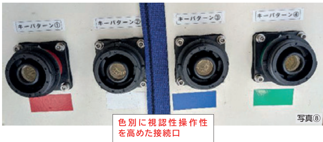
(写真) 非常時電源切替盤の作動状況
