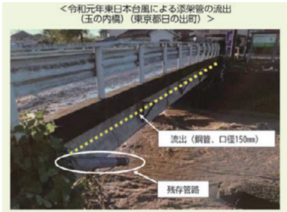
(写真) 令和元年東日本台風による添架管の流出 (東京都日の出町)
